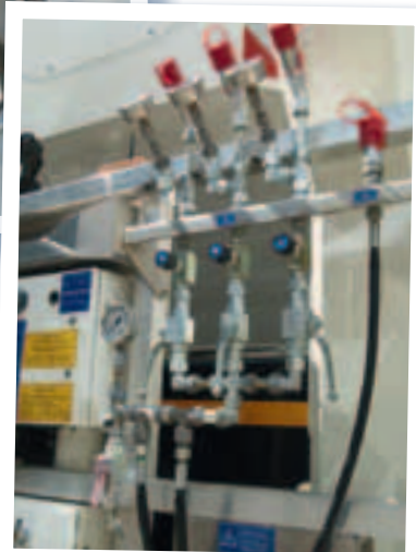
Die Anschlüsse für Strom, Wasser und Luft
