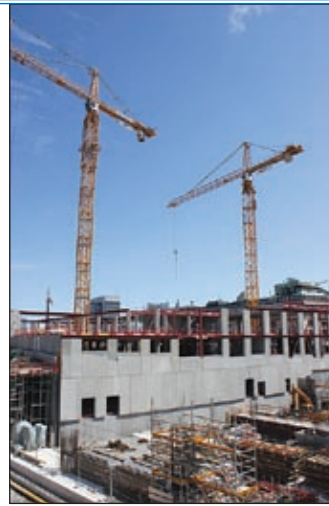
In einer ‚Public Private Partnership‘ errichten 13 Liebherr-Krane bis 2015 die neue Uniklinik in Stockholm. Derzeit sind acht montiert: vier 630 EC-H 40, drei 550 EC-H 20 sowie ein 20 SE.
