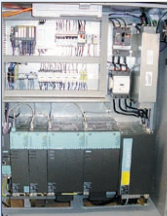
Einblick ins Herzstück der neuen Kransteuerung
