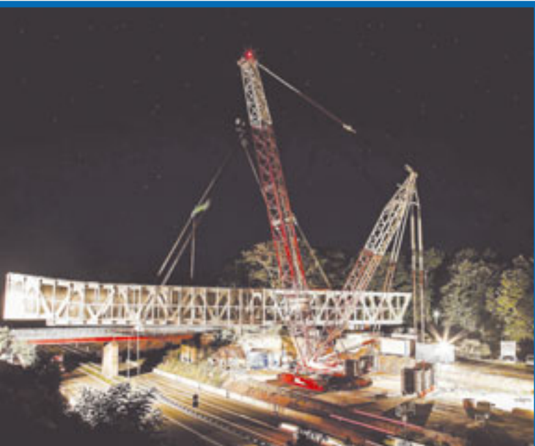
Der Krandienstleister Riga aus Mainz hat in einer Nachtaktion auf der A6 bei Kaiserslautern eine Fußgängerbrücke aus Stahl eingehoben. Im Zuge der Verbreiterung von vier auf sechs Spuren war dies nötig geworden. Dazu wurde die Autobahn 14 Stunden in beiden Fahrtrichtungen voll gesperrt. In diesem engen Zeitfenster musste Riga Mainz den Schwebeballast des Krans auf die Autobahn bringen, den Hub durchführen und die Autobahn wieder freigeben.
