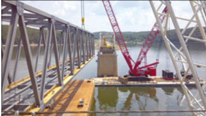
Bei einem heiklen 300-Tonnen-Hub auf dem Tennessee River hat der US-Vermieter Sterett seinen Kobelco SL4500R auf einer Barge aufgebaut, wo er zusammen mit einem 600-Tonnen-Raupenkran im Tandem eine Brücke eingehoben hat. Vorausgegangen war ein Unfall, bei dem ein mit Raketenbauteilen der NASA beladener Frachter ein 100 Meter hohes Brückenelement zerstörte.
