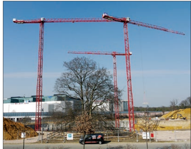
Am Frankfurter Flughafen entsteht der Stadtteil Gateway Garden. Damit der Flugbetrieb nicht beeinträchtigt wird, dürfen die Krane nicht über 180 Meter über Normalnull reichen. Hierbei kommen die spitzenlosen Modelle von Wilbert zum Tragen.
