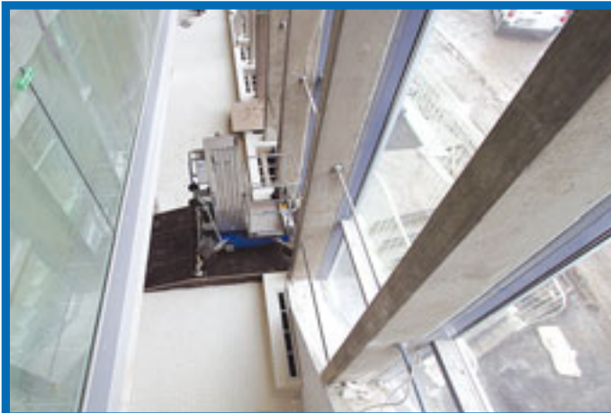
In der Schwimmoper in Wuppertal mussten die bis zu elf Meter hohen Fenster geputzt werden. Nur mit einem speziell angefertigten Podest konnte der Böcker-Personenlift die Kante vor den Fenstern überbrücken. „Der Einsatz einer Scherenbühne kam nicht infrage, da der Abstand zu gering war, um die Bühne parallel zu den Fenstern zu platzieren“, so Boris Spielhoff, Geschäftsführer von Spielhoff Arbeitsbühnen.
