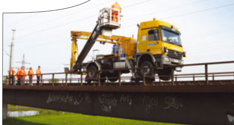
Mit der Rail-Road-Ausführung lässt es sich bequem an die entsprechenden Stellen der Brücke fahren
