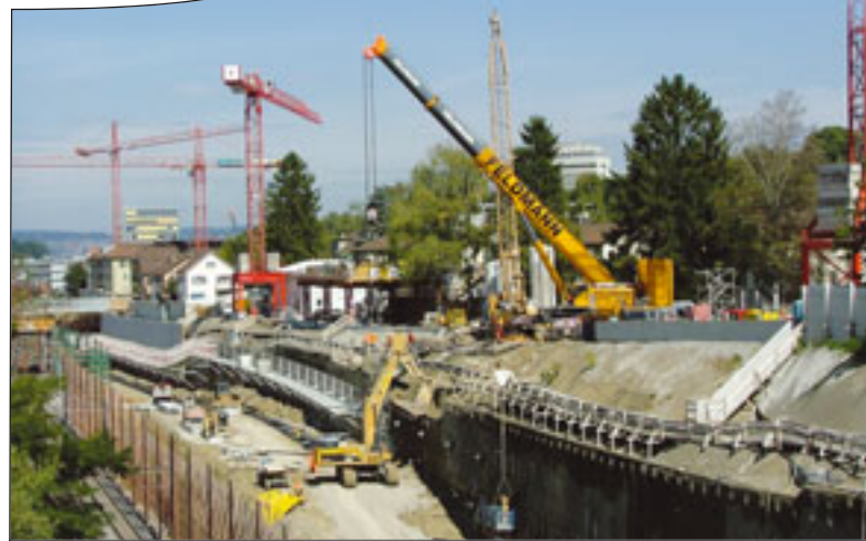
Für das neue Bahnprojekt Anschluss Weinbergtunnel im schweizerischen Oerlikon hat Kaufmann mehrere Turmdrehkrane geliefert
