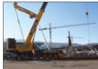
Beim Neubau des Letzigrund-Stadions kam nicht nur der große Demag-Raupenkran, sondern auch der AC 500-1 zum Einsatz
