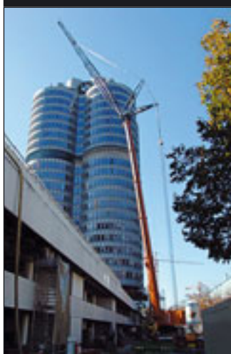
Ein AC 500-1 am BMW-Hochhaus in München
