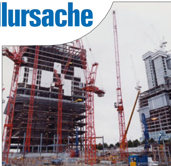
Die Großbaustelle Canada Square, wo sich im Mai 2000 der tödliche Unfall ereignete
