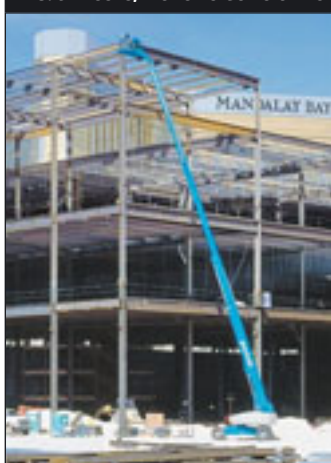
Teleskope haben ihre speziellen Einsatzzwecke, hier eine Genie S 125
