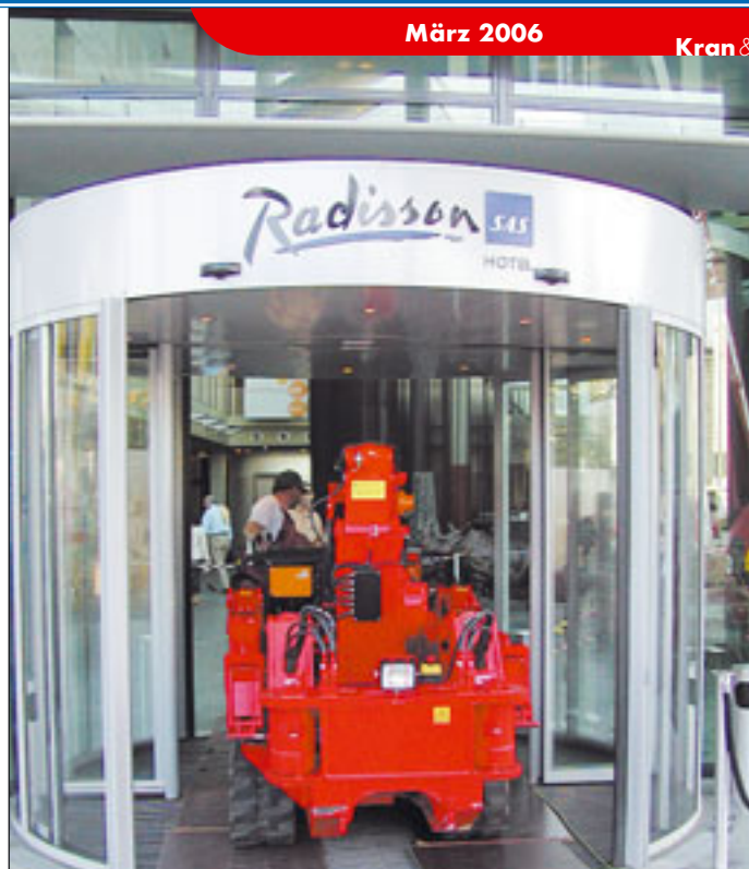
Mit dem niedrigeren Bodendruck und den kompakten Maßen sind Einsätze im Inneren von Gebäuden, wie diesem Hotel, auch für den Unic-Kran kein Problem
